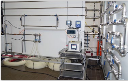
Bild 3: Prüfstand IWW mit Rohrleitungen und Messtechnik
